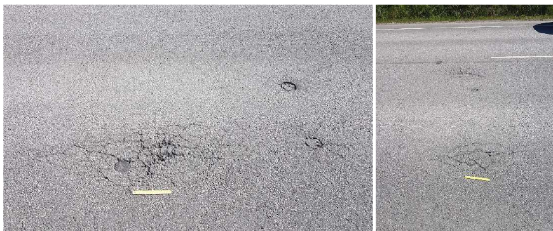
Joonis 7.1. Defektid km 14,577 (lõik E) ja km 15,044 (lõik D) viitavad sellele, et CFB tuhaga stabiliseeritud kihil on nõrk veepüsivus ja/või külmakindlus.
