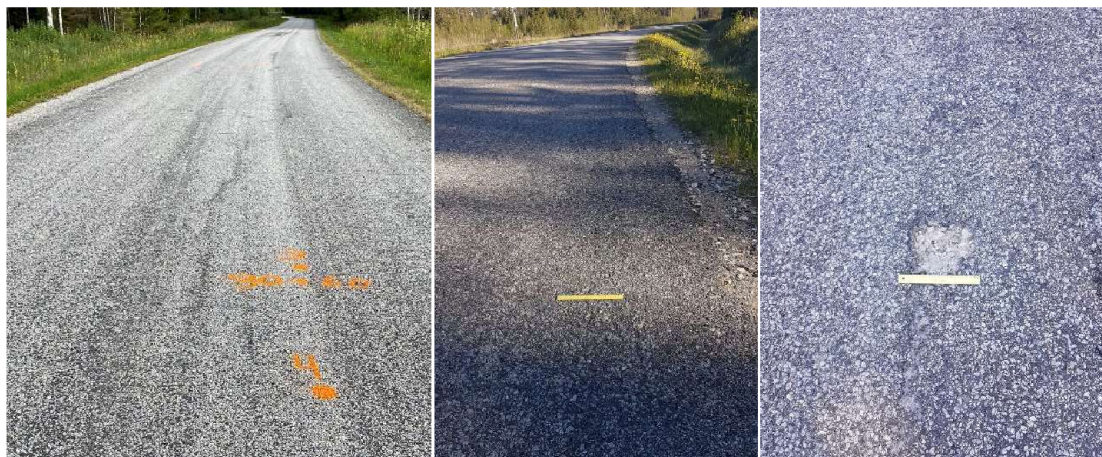
Joonis 7.10. Mass-stabiliseerimata turbaga lõigul tõenäoliselt külmakergetest johtuv pikipragunemine; KS lõigul leiduv võrkpragunemine; CFB tuhaga lõigul pindamiskihi irdumine/lagunemine.
