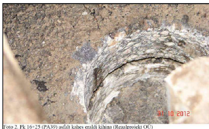
Foto 2. Pk 16+25 (PA39) asfalt kahes eraldi kihina (Reaalprojekt OÜ)
